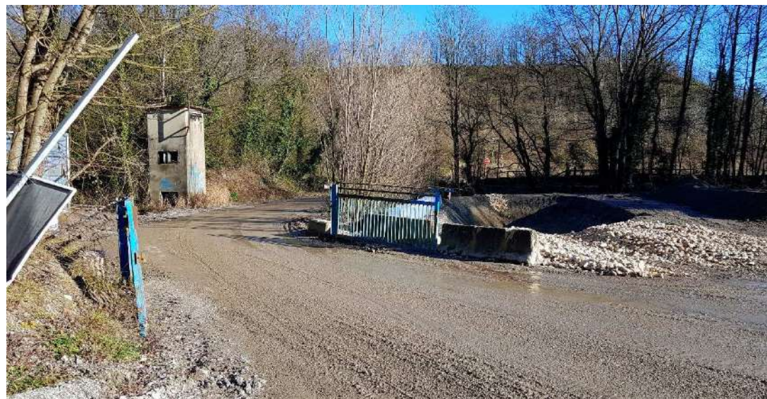
Photographie 3 : Illustration du portail d'accès et du bassin de décantation des eaux pluviales
